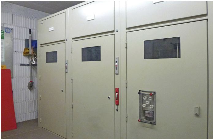
Trafo Räume für WIG-Schweißgeräte werden mit besonders hoch beladenen Frequenzmodulatoren bestückt.
